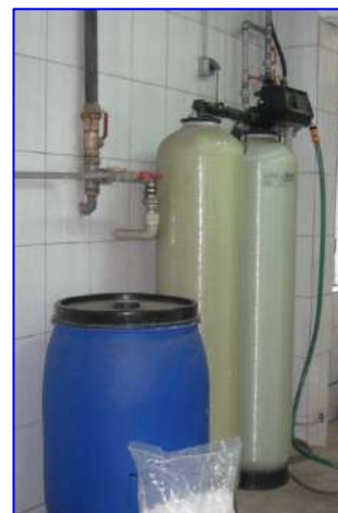
Слика бр. IV.1-5: Колона за омекнување на напојната вода за котлите
