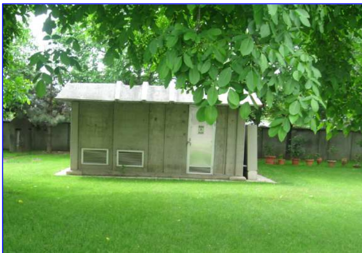
Слика бр. IV.1-1: Трафостаница од која инсталацијата се снабдува со електрична енергија
